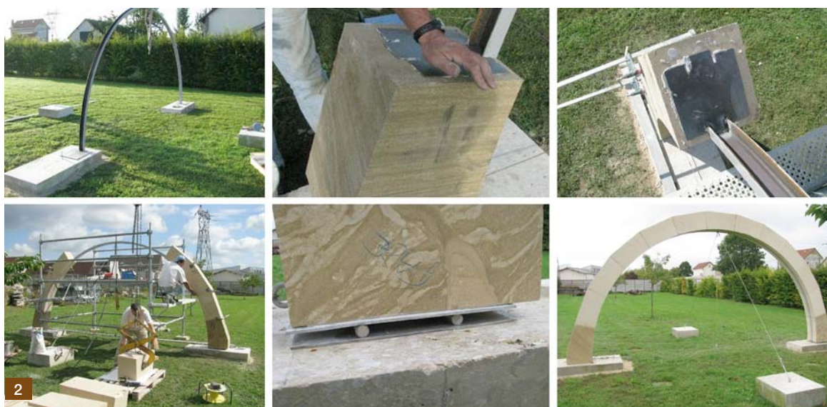
2. Phases de la construction de l'arche, lames en acier et en particulier une attaque au sol. Photo G. Fallacara.
