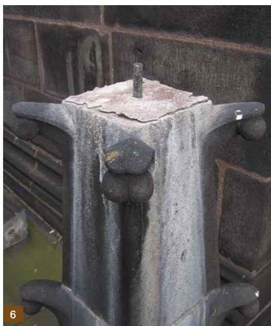
5. Clermont-Ferrand, cathédrale, maçonnerie extérieure du chantier de Viollet-le-Duc, mortier de chaux et scellement au plomb.
